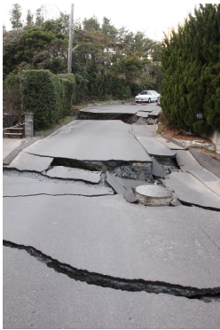
写真 道路の被害 (銚田市・東日本大震災)
