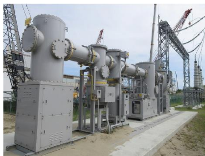
ガス絶縁開閉装置（変更後）
