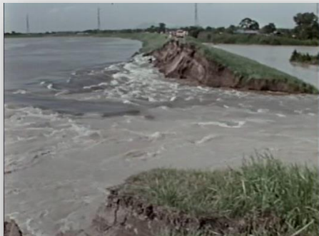
決壊した小貝川堤防
