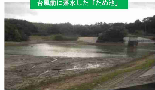
台風前に落水した「ため池」
