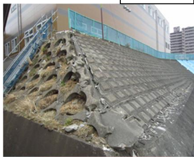
法枠・張ブロックの崩壊
