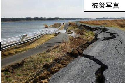
堤防・護岸の崩壊
