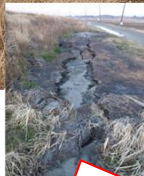
川裏の液状化
