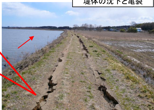
堤体の沈下と亀裂
