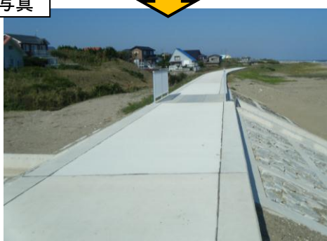
水路脇の擁壁・通路、法枠が沈下及び破損したため元の高さに復旧しています。
