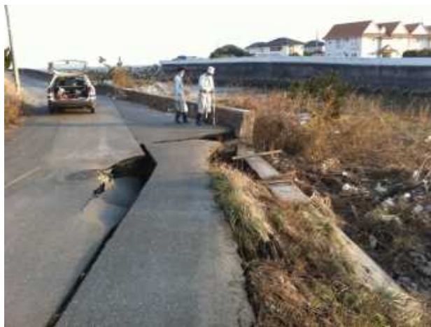
図 1-10(2) 津波により被災した護岸
