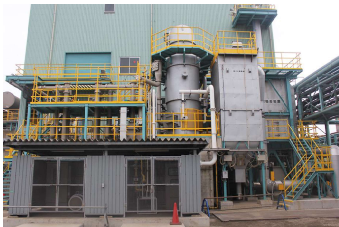
ガス洗浄設備
