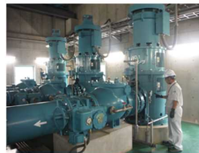
機械電気設備の点検業務
