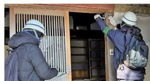
能登半島地震で活動する応急危険度判定士 （R6.1 石川県津市市）
