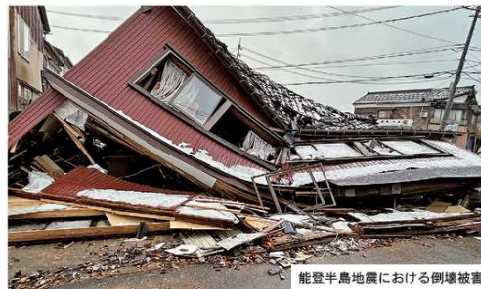
能登半島地震における倒壊被害
