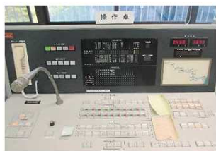
ダム制御処理設備
