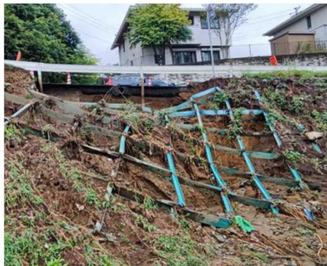
法下から撮影 敷地法面崩落
