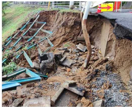
法上から撮影 敷地法面崩落
