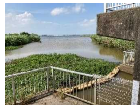
侵入防止フェンスへの堆積
