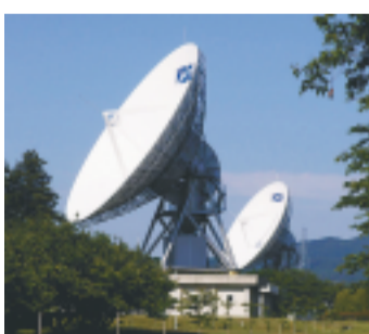
KDDI茨城衛星通信セン ター・パラポラアンテナ
