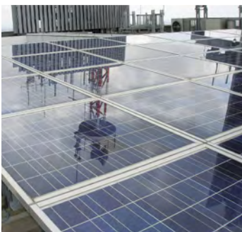
太陽光発電パネル(県庁舎屋上)
