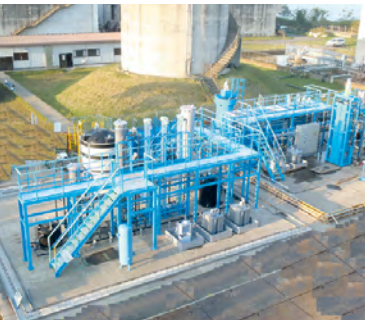
新たな浄水処理技術の実証実験施設
