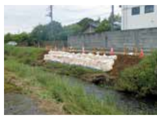
大雨により被災した宮戸川
