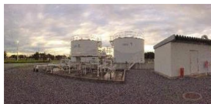
給油施設（燃料タンク2基）
