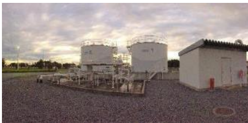
給油施設（燃料タンク 2 基）
