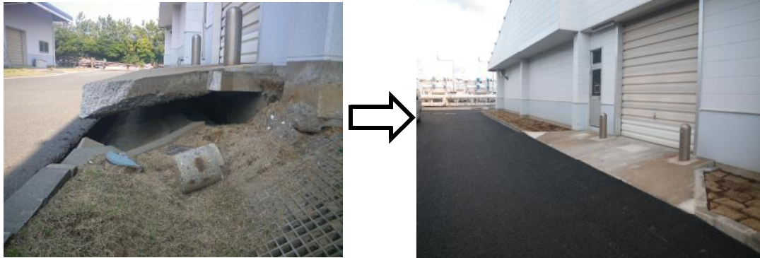
被災前（液状化・地盤沈下）
