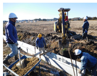
地域住民の直営施工による排水路整備 (常陸大宮市小倉地区)
