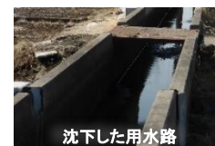
沈下した用水路
