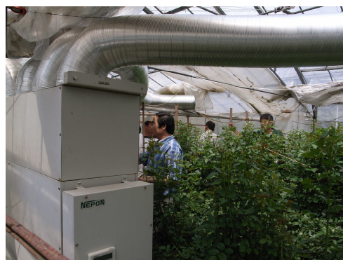
図Ⅱ-2-11 室内機とダクト
