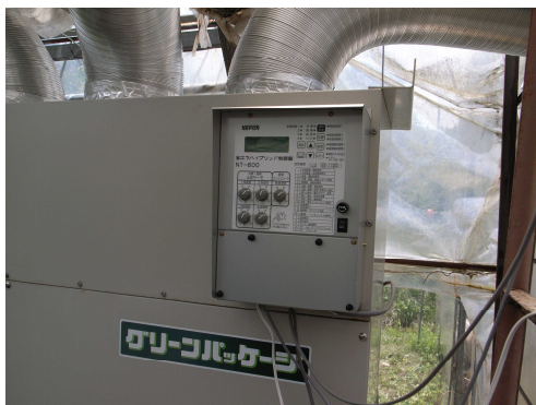
図Ⅱ-2-10 室内機とハイブリッド制御盤
