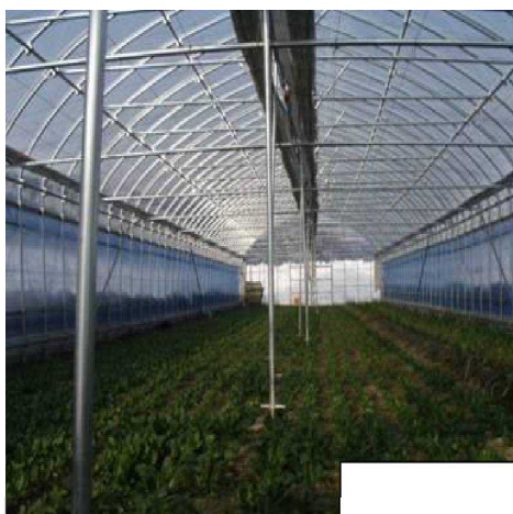
図1 耐雪支柱の設置事例（福井県雪害対策マニュアルより）
