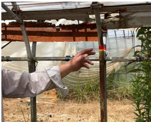
写真1 谷部の雨樋部分の腐食
