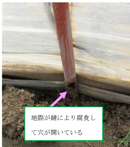
写真1 脚部の腐食状況
