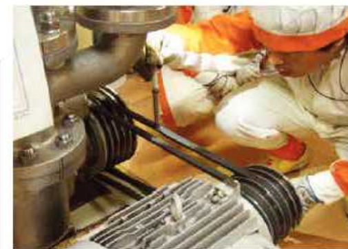
④ 点検保守(排風機のベルト交換)
