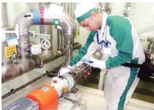
③ 月例点検(冷却水ポンプ)
