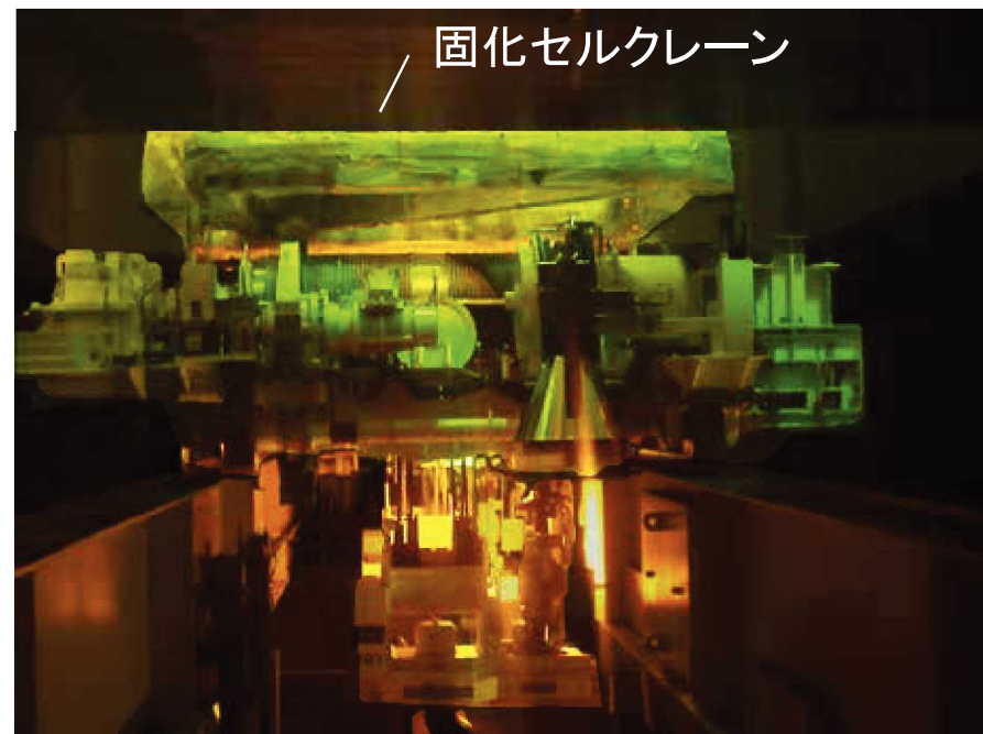
固化セルクレーン
