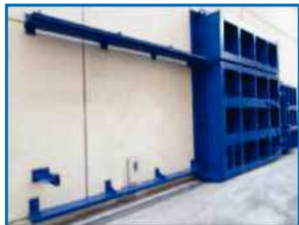
浸水防止扉(設置済み)
