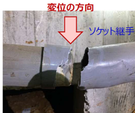
破断配管A 破断部
