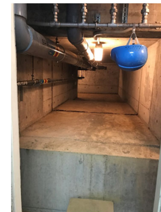
第四実験棟 管理区域外配管
