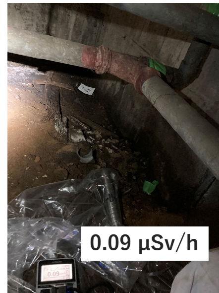
脱落箇所B
