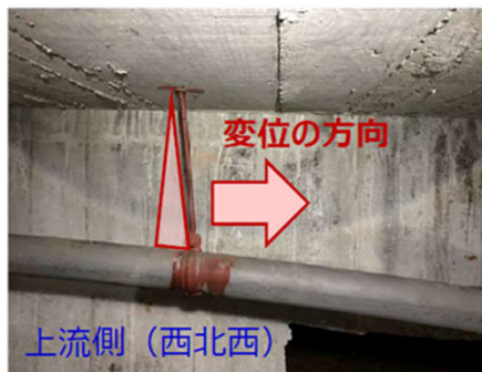
破断配管A 上流側吊り金具
