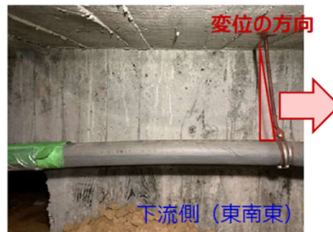
破断配管 A下流側吊り金具
