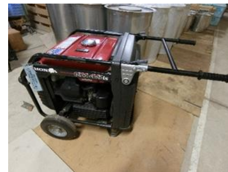
整備予定の可搬型発電機
