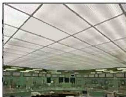
通常点灯時 (常用照明及び非常用照明点灯)
