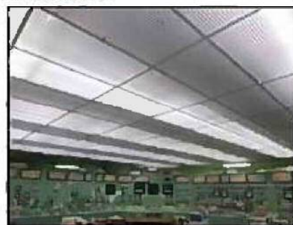
非常用照明点灯時 (常用照明消灯)
