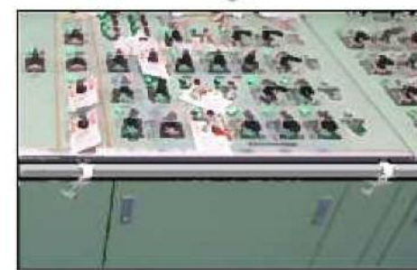
対策後設備 (手摺設置イメージ) 主制御盤への手摺の設置
