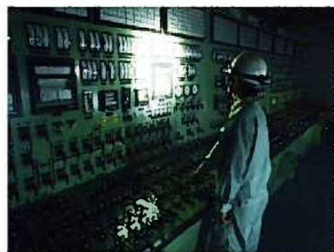
(シミュレーション施設におけるヘッドライト使用状況) ヘッドライト使用状況
