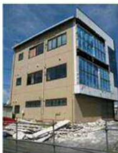
瓦礫は建屋周辺に堆積
