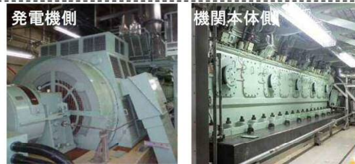
非常用ディーゼル発電機
