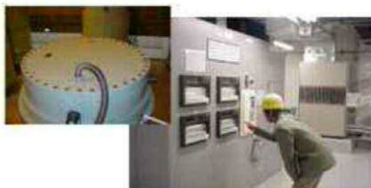
二重蓋間圧力監視(密封性確認)
