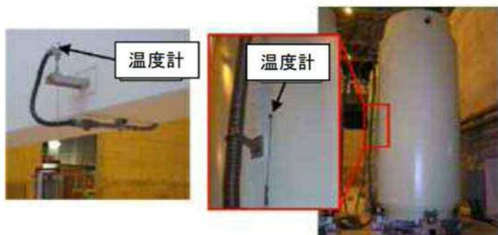
給排気口温度及び貯蔵容器表面温度 (冷却性確認)
