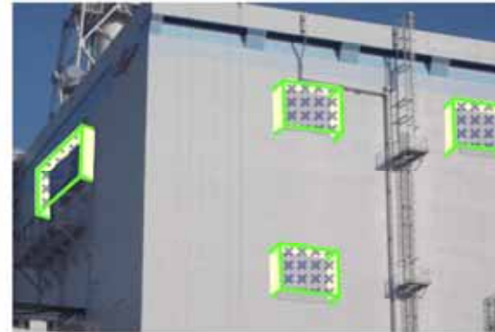
原子炉建屋外側ブローアウトパネル
