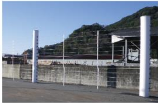
津波漂流物捕捉施設
