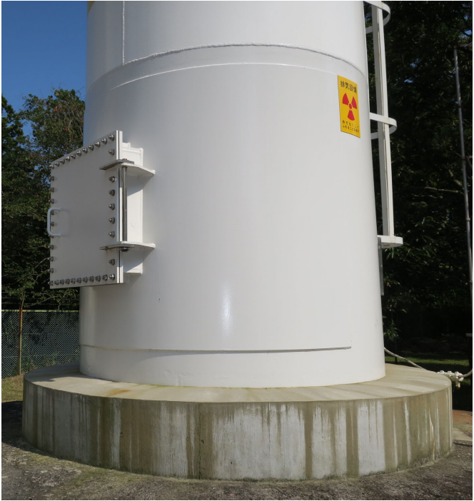
点検口を持つ排気筒の例 （本センターホットラボ実験棟排気筒）
