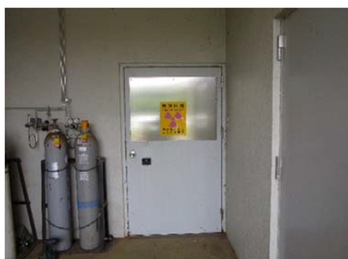
研究棟ローディング ドック
