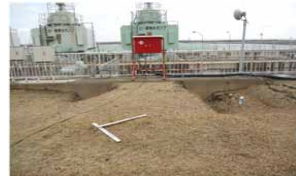
写真② 地盤沈下
