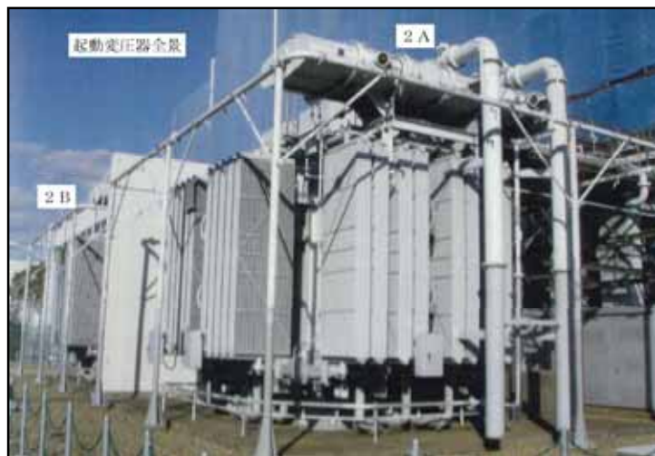
起動変圧器全景A
