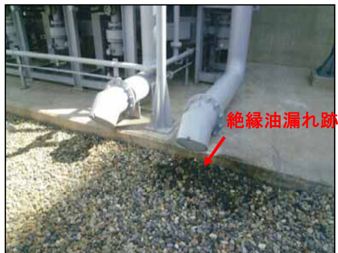
起動変圧器2A
