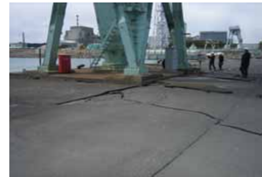
写真⑤ 地盤沈下
