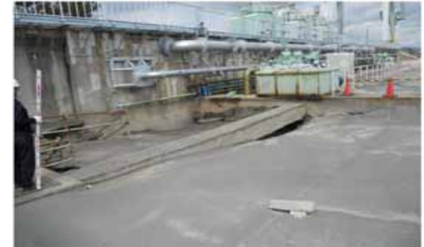
写真① 液状化(地盤沈下)
