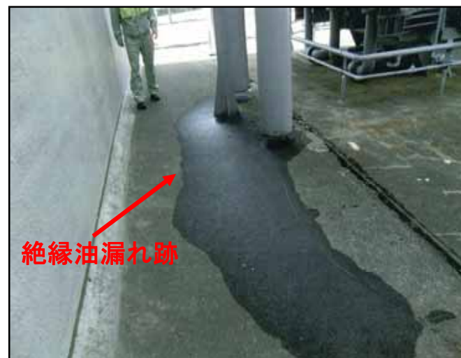
起動変圧器2B
