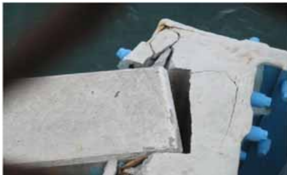
写真③ 躯体変形(カーテンウォール端部)
