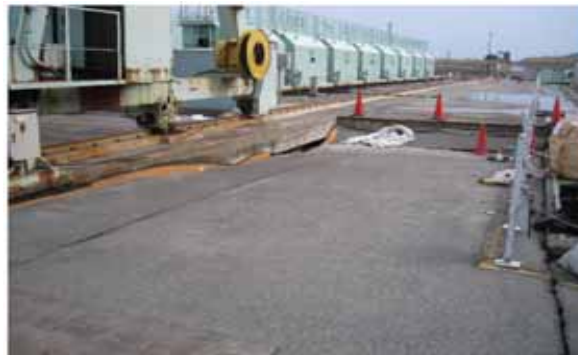
写真④ 液状化(地盤沈下)
