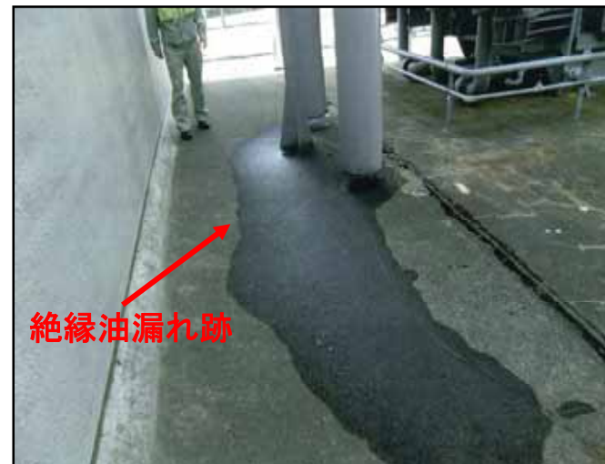
起動変圧器2B
