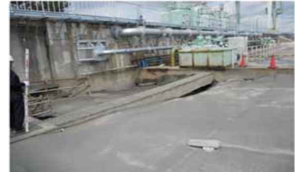
写真① 液状化(地盤沈下)
