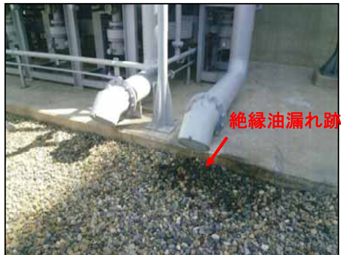
起動変圧器2A
