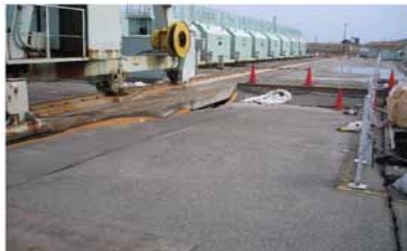
写真④ 液状化(地盤沈下)
