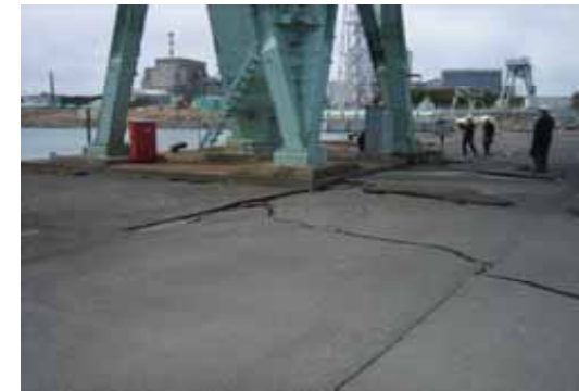
写真⑤ 地盤沈下
