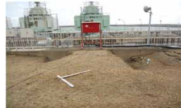
写真② 地盤沈下
