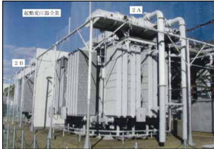
起動変圧器全景A
