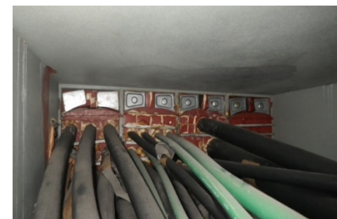
ケーブル貫通部
