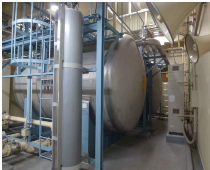
廃液貯槽室(タンク)
