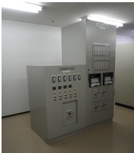
中央制御室外原子炉停止盤 (原子炉制御棟)
