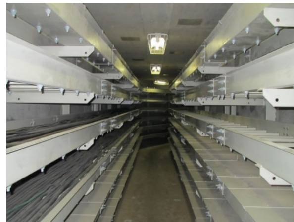
鋼材製ダクトによる ケーブル分離
