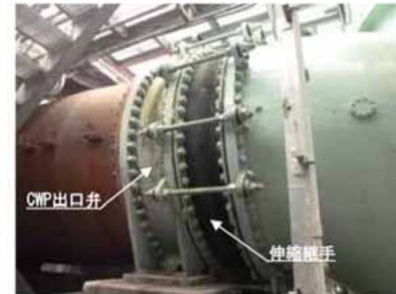
図6.16 循環水ポンプ出口管及び伸縮継手
