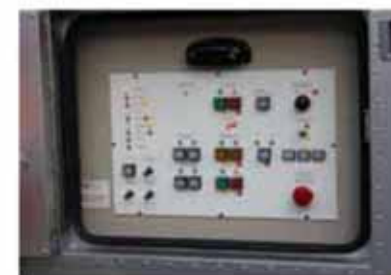
操作盤(低圧電源車)
