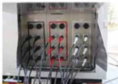
ケーブル接続箇所(低圧電源車)
