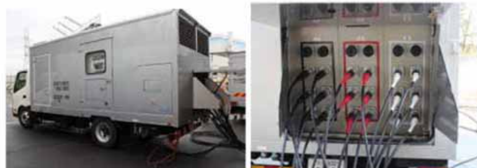
ケーブル接続箇所(低圧電源車側)
