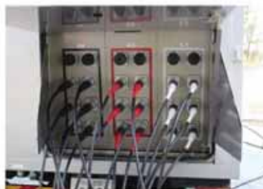
ケーブル接続箇所(低圧電源車)
