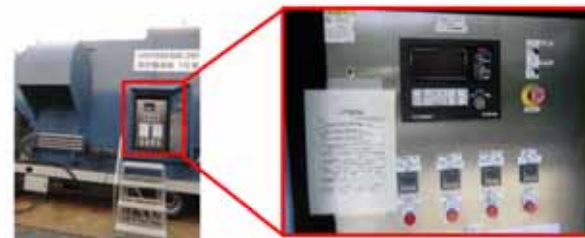
現場操作盤 (高圧電源装置)
