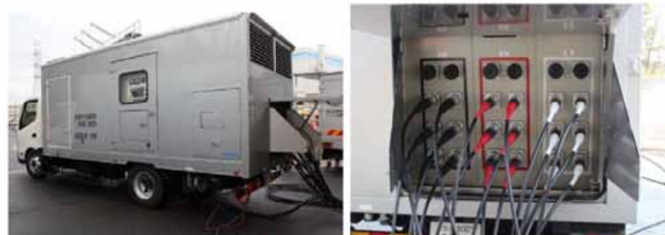
ケーブル接続箇所(低圧電源車側)
