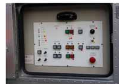
操作盤(低圧電源車)
