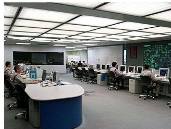
東京ガス(株) 供給指令センター
