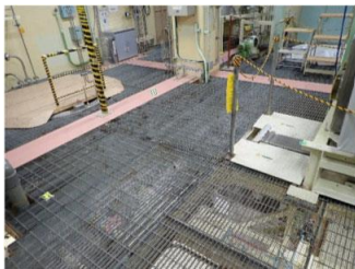
②の例(グレーチング)
