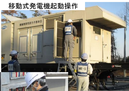
移動式発電機起動操作
