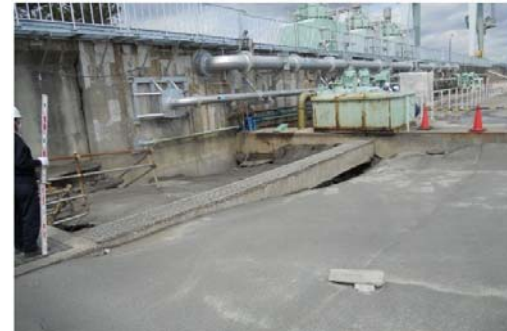
写真①: 地盤の沈下状況(取水口エリア)
