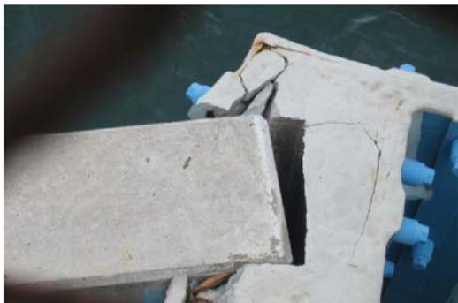
写真③: 躯体の変形
