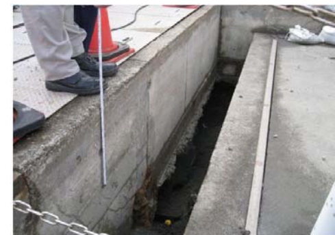
写真⑤: 地盤沈下に伴う段差の発生(取水口エリア)
