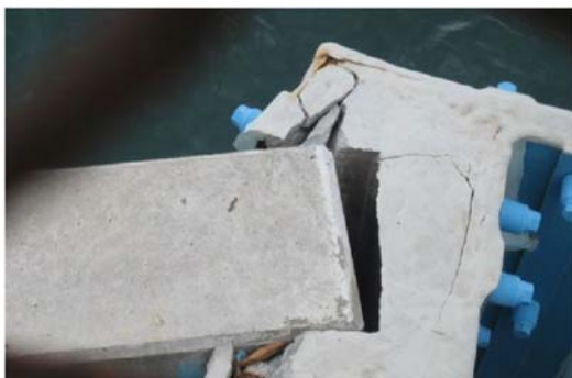
写真③: 躯体の変形
