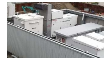
非常用ガスタービン発電機 (屋上設置)
