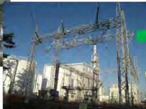
気中開閉所(取替前)
