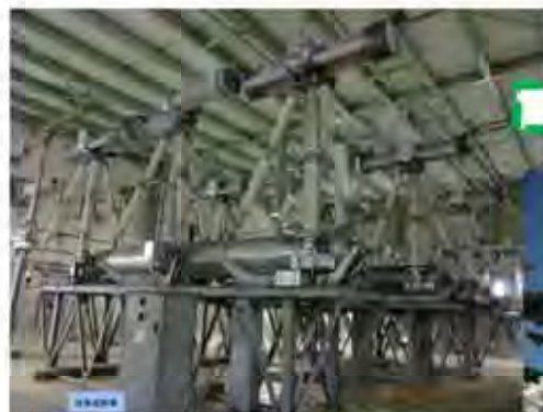
気中開閉所(取替前)
