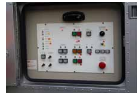
操作盤(低圧電源車)
