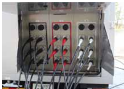
ケーブル接続箇所(低圧電源車)
