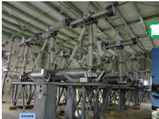
気中開閉所(取替前)
