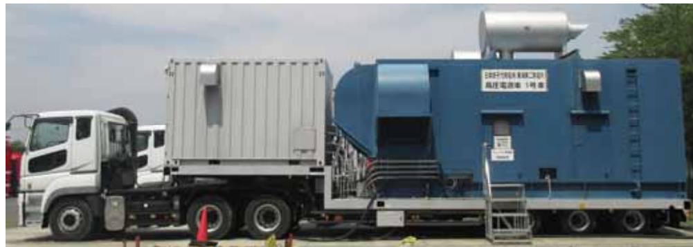
常設代替高圧電源装置(5台設置+予備1台)
