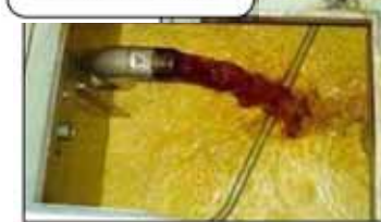
写真② 主油タンク油面(泡)
