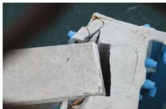
写真③: 躯体の変形
